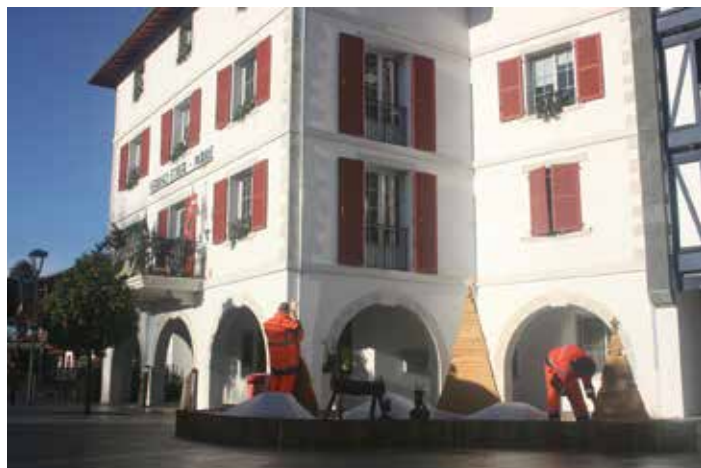
Les services techniques ont été à pied d'œuvre pour installer les décorations de Noël et les illuminations.
